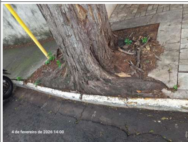
Imagem 05. Situação do passeio público (exemplar nº 1).
